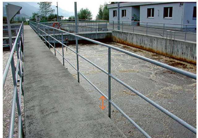
22 Aus betrieblichen Gründen (Schneeräumung) wurde an diesem Laufsteg in einer Kläranlage keine Fussleiste angebracht. Sie wurde durch eine zusätzliche Knieleiste ersetzt. In diesem Fall darf der Abstand zwischen der Lauffläche und der untersten Knieleiste nicht mehr als 300mm betragen.
