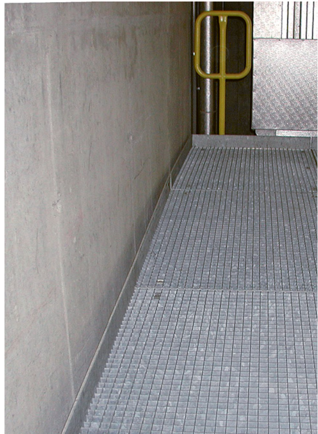
8 Fussleiste zur Sicherung der maschinen- bzw. wandseitigen Absturzkante. Die Fussleiste ist erforderlich, weil der horizontale Abstand der Laufebene zur Wand bzw. zur Maschinenverkleidung mehr als 20 mm beträgt. Im Bereich des Hintergrunds, wo der Abstand 180 mm überschreitet, wurde ein Geländersegment angebracht.
