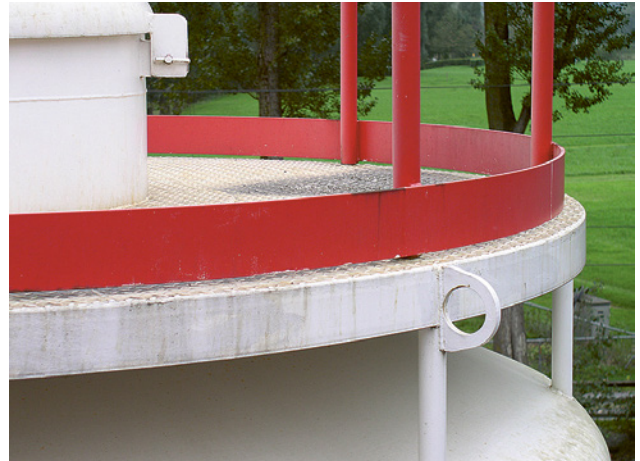
21 Durch den Freiraum zwischen Lauffläche und Fussleiste kann Regen- und Schmelzwasser abfließen. Der Freiraum beträgt nicht mehr als 12mm.
