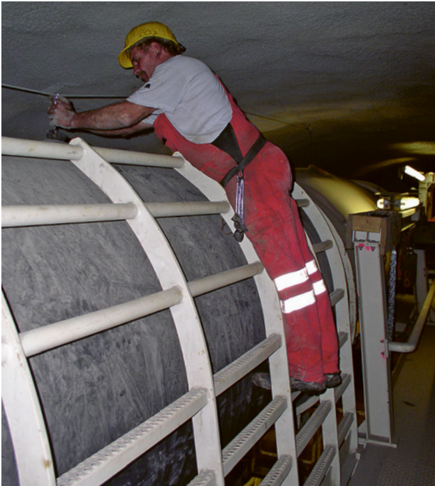
12 Arbeiten über ein Geländer hinweg. Die Gestaltung des Geländers, insbesondere dessen Höhe, entsprechen den besonderen sicherheitstechnischen und betrieblichen Erfordernissen.
