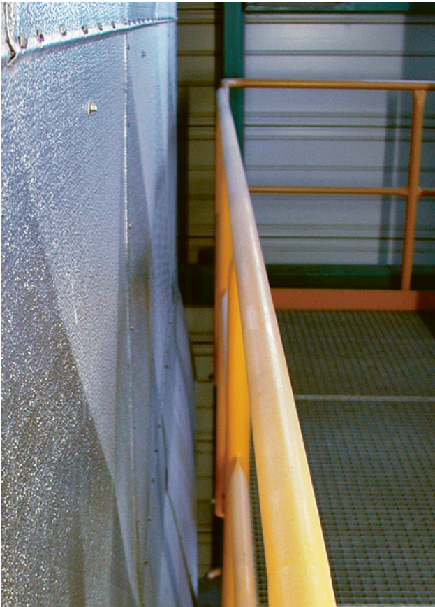
7 Geländer zur Sicherung der maschinen- bzw. wandseitigen Absturzkante. Das Geländer ist erforderlich, weil der Abstand der Laufebene zur seitlichen Maschinenverkleidung bzw. zur Wand mehr als 180 mm beträgt.
