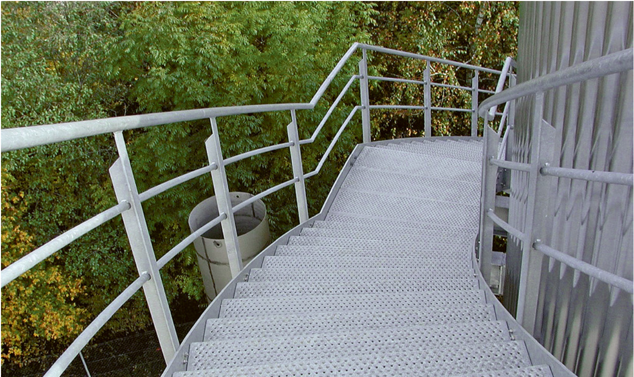
16 Treppengeländer mit zwei Knieleisten. Der Abstand (lichte Weite) zwischen Handlauf und oberer Knieleiste, zwischen den Knieleisten sowie zwischen der unteren Knieleiste und der Treppenwange beträgt nicht mehr als 500mm. Die erforderliche Anzahl an Knieleisten richtet sich nach der Funktion des Geländers.
