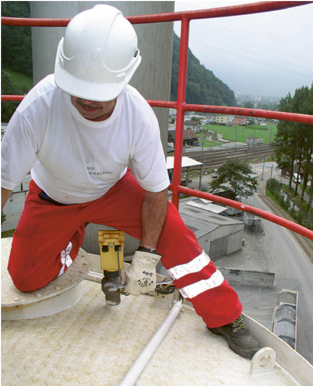
19 Die Fussleiste von mindestens 100mm Höhe verhindert, dass Personen bei Wartungsarbeiten unter dem Geländer wegrutschen oder, dass Gegenstände hinunterfallen und Personen gefährden.
