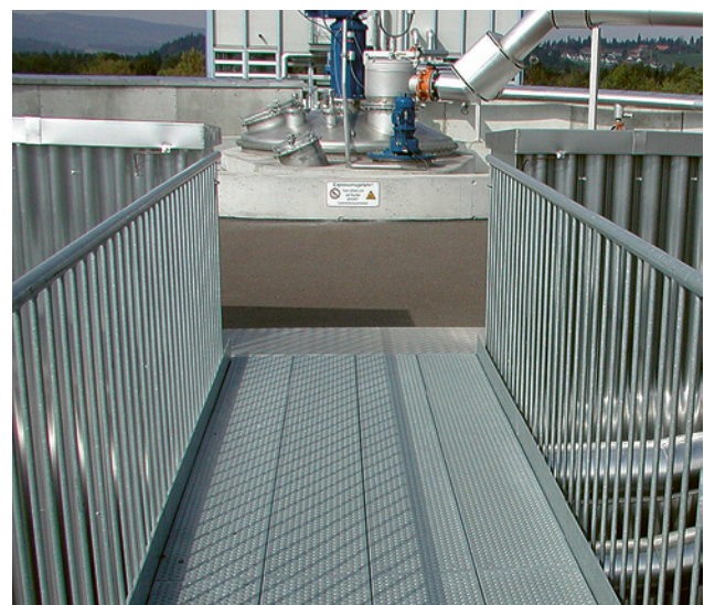
18 Geländer mit vertikalen Füllstäben. Der Abstand der Stäbe (lichte Weite) beträgt nicht mehr als 180mm.
