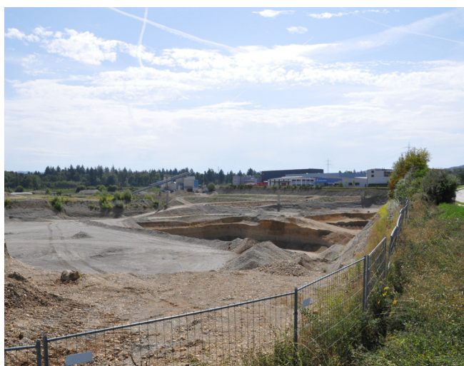
Abbildung 7: Grundstück heute - Pestalozzistrasse, im Vordergrund der Kiesabbau, der durch Kibag AG betrieben wird
